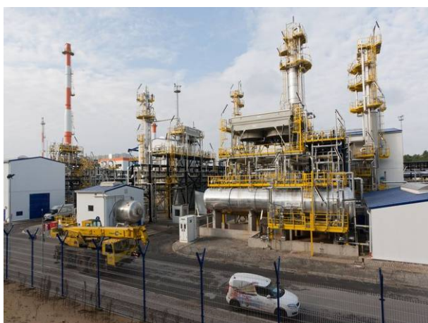
Rys. 13. Kopalnia Ropy Naftowej i Gazu Ziemnego Lubiaków-Międzychód-Grotów PGNiG w okolicach Grotowa źródło: www.pgnig.pl
