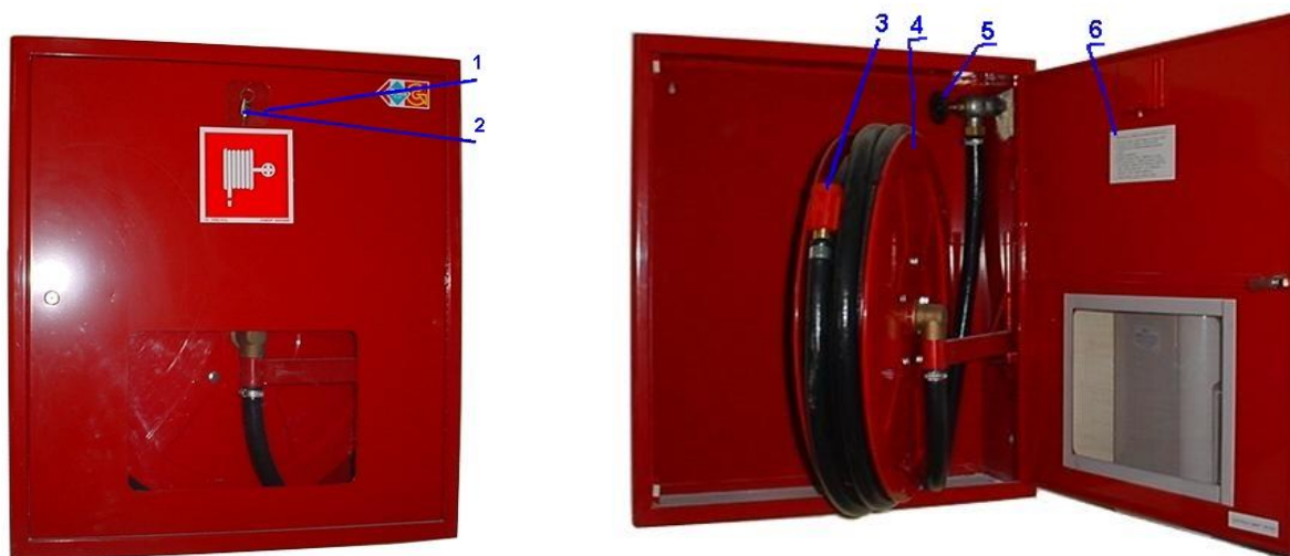
Zdjęcie hydrantu wewnętrznego z węzem półsztywnym 25
