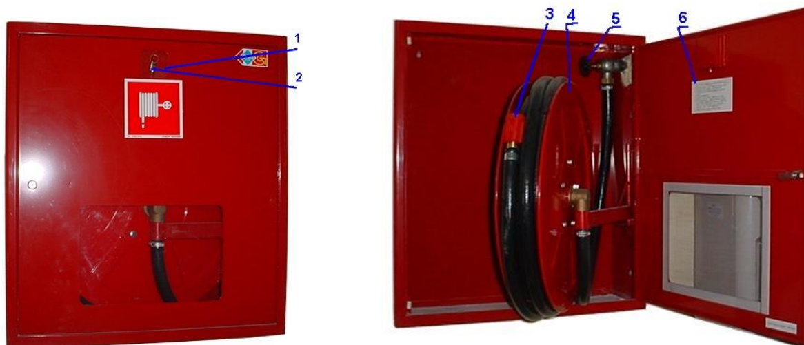
Zdjęcie hydrantu wewnętrznego z węzem półsztywnym 25
